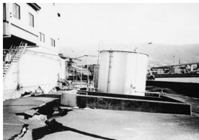
写真2-3 被災した東クリーンセンター
