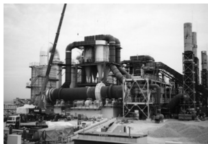
写真2-8 大型キルン炉
