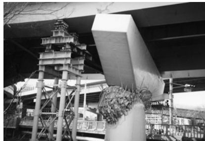
写真2-2 破断した橋脚
