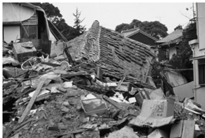
写真1-1 淡路島における破損家屋
